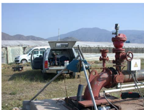
Figura c.1.2. - Instalación de tubo de PVC en punto 782-D (AIO, área de Pampanico)
